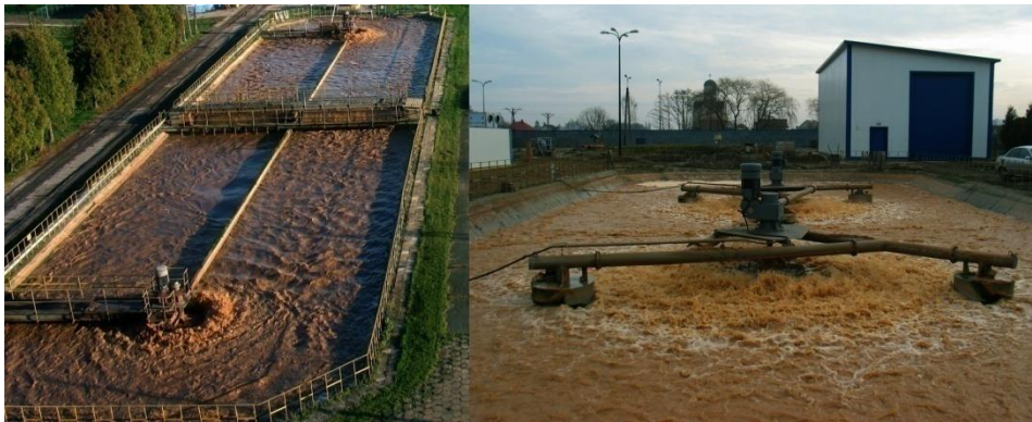
Rys. 2. Widok na reaktor biologiczny przed i po modernizacji- oczyszczalnia Bielmlek Bielsk Podlaski
