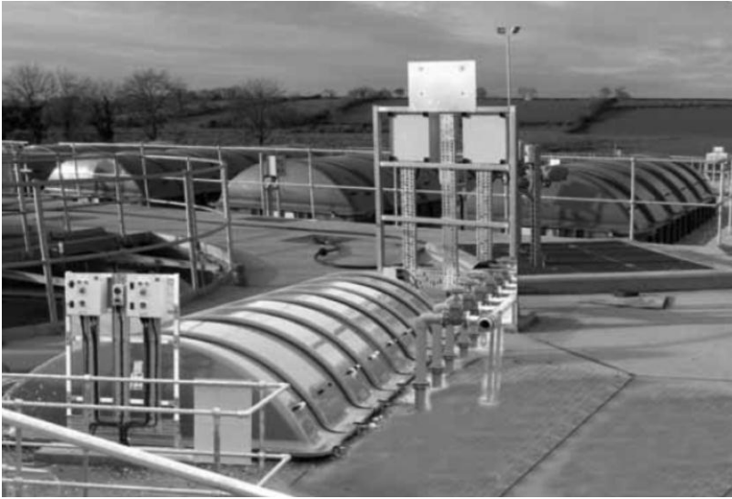
Rys. 4. Oczyszczalnia typu DN19S RBC – Kinallen, północna Irlandia Fig. 4. The wastewater treatment plant DN19S RBC – Kinallen, Northern Ireland
